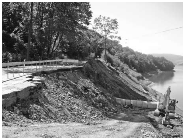
Osuwisko na drodze powiatowej w Lipiu
